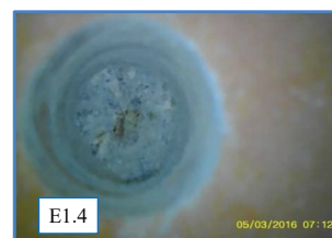
E1.4: Scatto eseguito a circa fine foro: fine laterizio forato ed inizio soletta in calcestruzzo.
